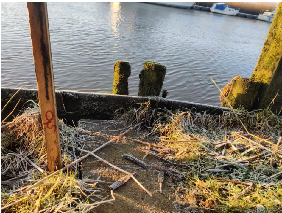
Figur 3: Flisen ligger i kote 0,5m DVR. Kanten af pladerne på den nuværende brinksikring stikker ca. 10 cm længere op, end den tilladte kote jf. Administrationsgrundlaget.
